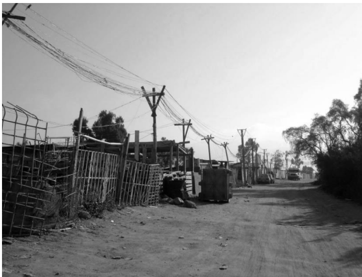
Lámina #44.- Perspectiva típica de un asentamiento ilegal, lo precario y peligroso de la instalación eléctrica en la Ciudad de Tijuana, B.C. hecho común en la periferia de las ciudades en México.
