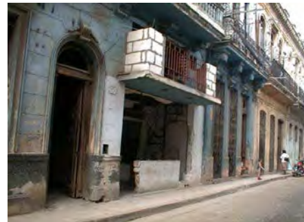
Falta de control, escaleras, entresijos e inserciones inadecuadas. Fuente Archivo IPF
