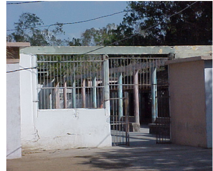
Deterioro de instalaciones interiores de La Feria (círculo social). Fuente Autora
