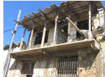
Falta de capacidad técnica para acometer las obras, ya sean estatales o privadas. Fuente Archivo IPF
