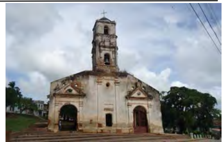
Inmueble a punto de perderse por la falta de mantenimiento. Fuente Autora
