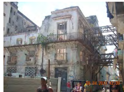
Alto grado de deterioro, incremento de las vulnerabilidades de las zonas más antiguas. Fuente Autora
