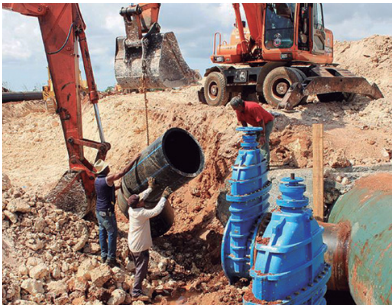
Imagen 11. Inversiones para el mejoramiento del abasto de agua potable a La Habana.
